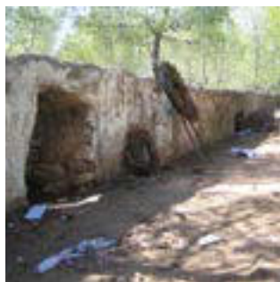
Estado actual del Paredón, se observa cómo está prácticamente colmatado de tierra y escombros. Además, la estructura ha sufrido repetidamente diferentes actos vandálicos, como pintadas.
